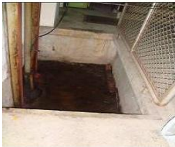
地下室之升降梯孔積水
