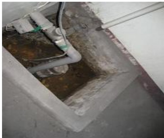
地下室儲水槽
