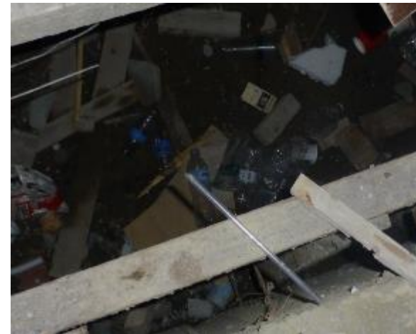
建築工地廢棄物堆積處
